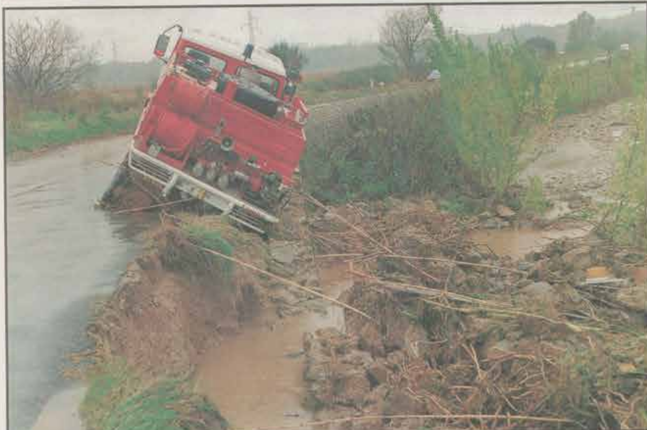
CAPENDU (AUDE). - La route, aspirée par les flots, qui se dérobe sous les véhicules, a constitué un piège mortel pour de nombreux automobilistes. Totalemment imprévisible. Les secours, contraints de s'engager sur des voies incertaines, n'y ont pas échappé, obligés parfois d'abandonner leurs camions en mauvaise posture.
