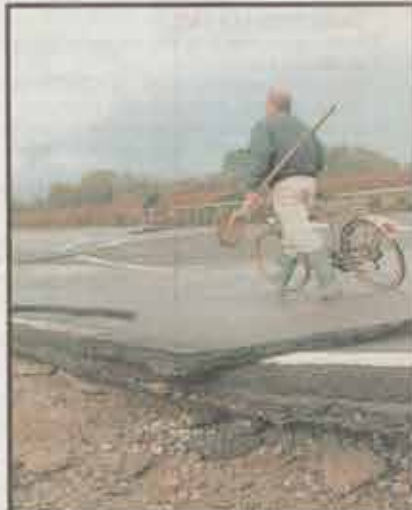
VILLEDAGNE (AUDE). - Les plaques de bitume de la nationale 113 ressemblent à un mille-feuille, tantôt superposées, tantôt portées sur plusieurs mètres par les eaux.
